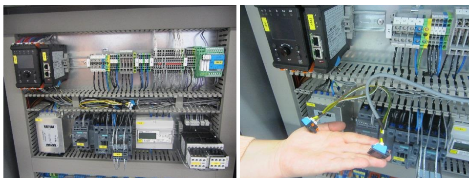
Abb. 5 Offener Kabelkanal mit inliegendem Anschlusskabel (blaue Stecker)
